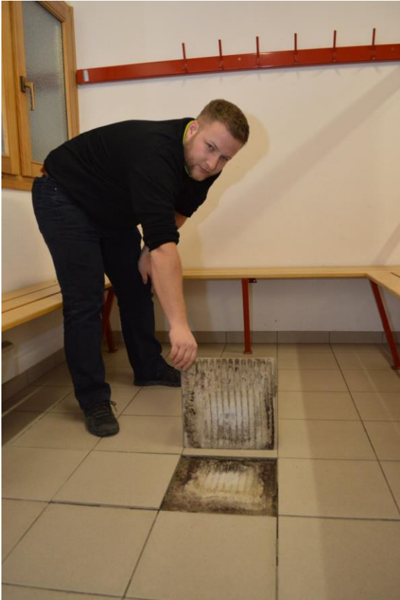
Bildlegende: Ralf Schneider, Mitglied der Subkommission, zeigt, dass ein grosser Teil der Bodenplatten lose ist. Nebst diesen sichtbaren Schäden werden noch viel gravierendere, verdeckte Schäden und Mängel vermutet.
