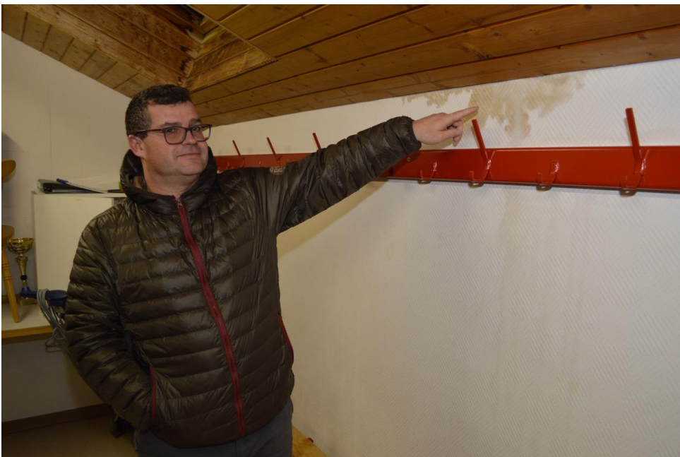
Bildlegende: Abplatzungen des Verputzes und Verfärbungen des Mauerwerkes deuten gemäss Aldo Frei vom Sportplatzkonsortium darauf hin, dass Wasser in das Mauerwerk eindringt.
